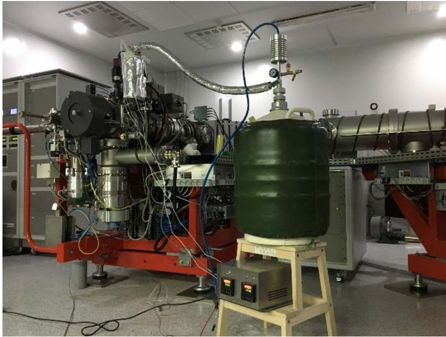
图 2 全自动液氮加注系统实物图
